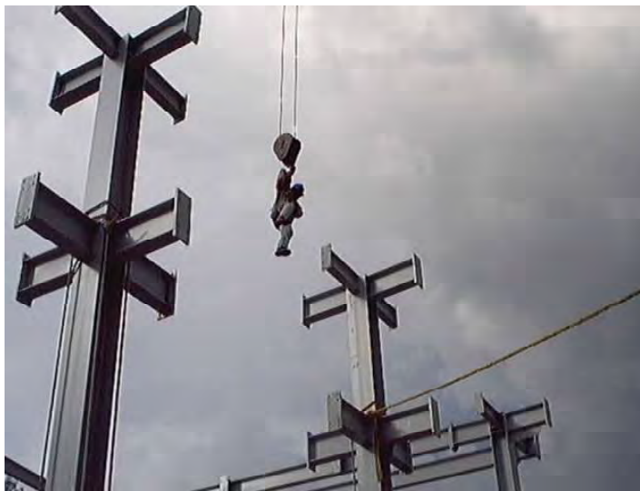
UNIVERSIDAD NACIONAL DE COLOMBIA, MANIZALES, CAMPUS LA NUBIA (Construcción de estructura metálica)
