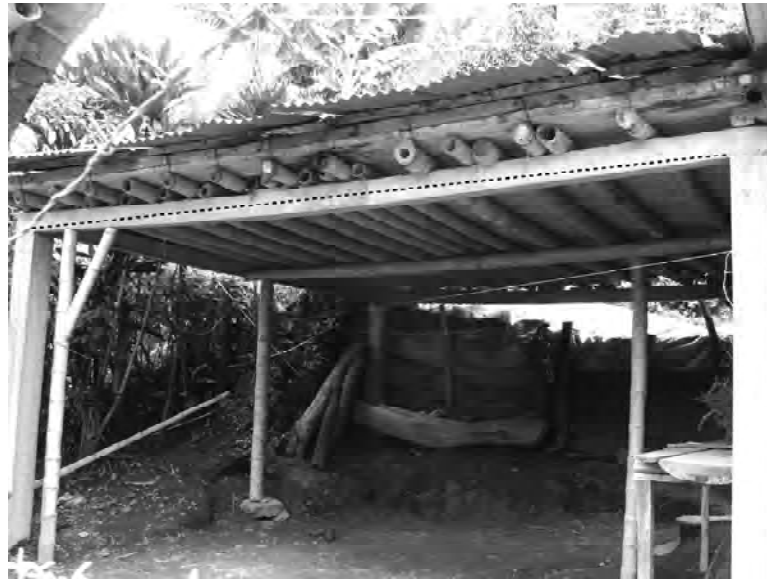
NÓTENSE LAS DEFORMACIONES Y FISURAS EN LOS EXTREMOS DE LA VIGA
