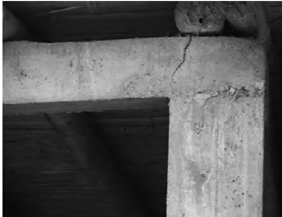
NÓTESE AGRIETAMIENTO DE LA VIGA EN LA SECCIÓN DE MOMENTO NEGATIVO, POR FALTA DE REFUERZO
