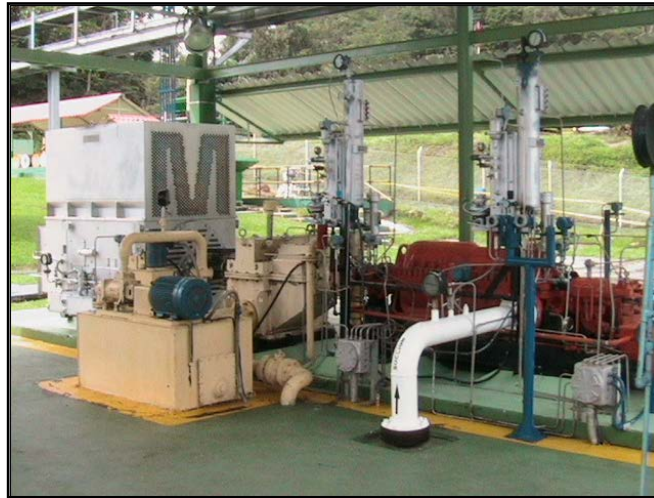
Figura 5: Unidad de bombeo principal Planta Mariquita. Fuente: Ecopetrol S.A.
