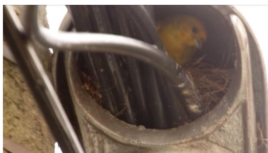
Figura 1: Nido de Cucarachero en cableado de alumbrado público 1 .
